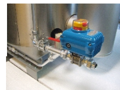
Automatisches Abschlammventil, handbetrieb möglich
