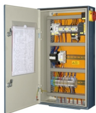
Elektro-Schaltschrank mit Siemens-SPS-Steuerung
